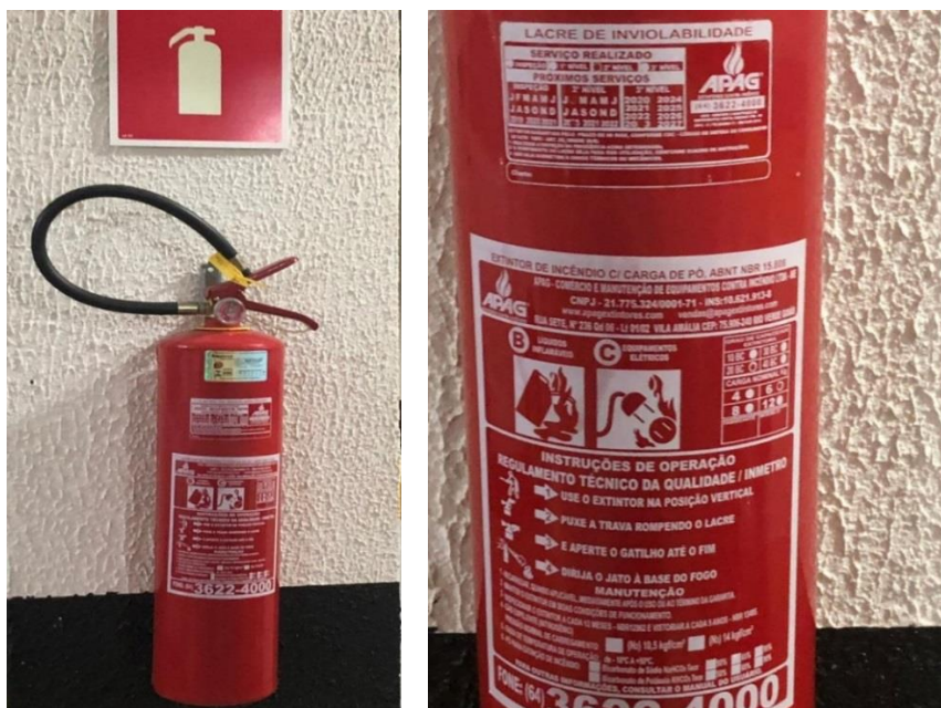
Figura – 10: Extintor de Incêndio (Prédio C) Fonte: Próprio Autor (2019)
