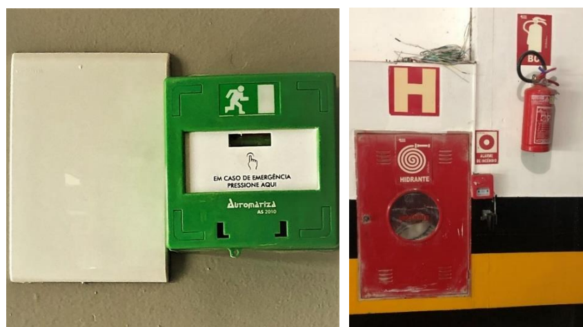
(a) (b) Figura – 4: (a) Alarme e (b) Hidrante (Prédio A)
