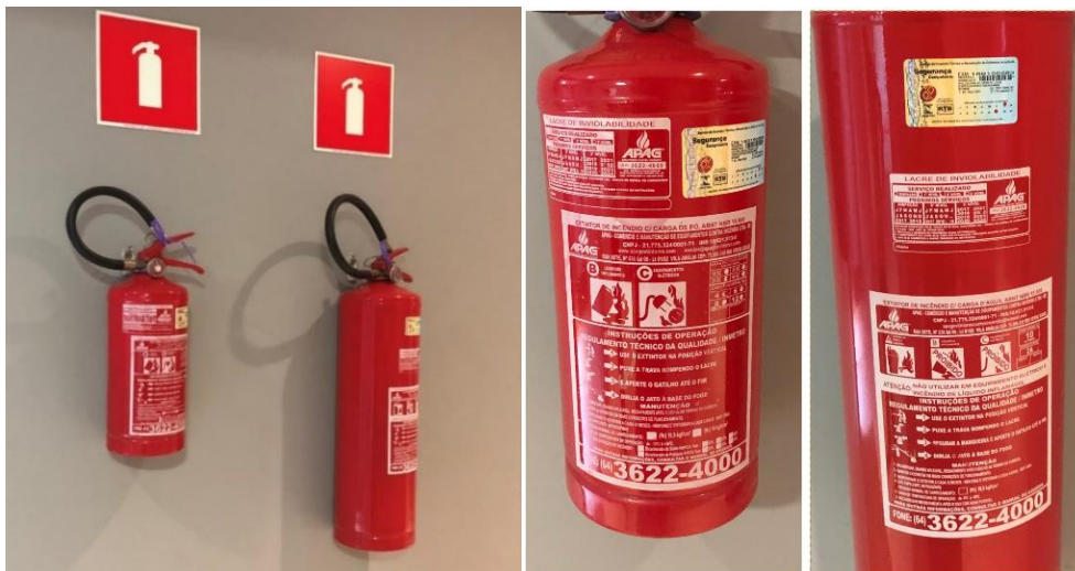
Figura – 3: Extintores de Incêndio (Prédio A) Fonte: Próprio Autor (2019)
