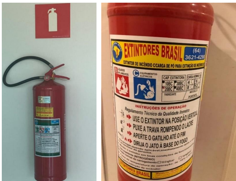
Figura – 7: Extintores de Incêndio (Prédio B)
