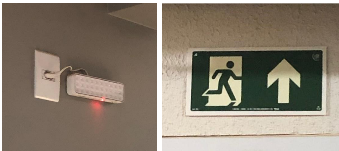
(a) (b) Figura – 11: (a) Iluminação de Emergência e (b) Placa Indicando Saída de Emergência (Prédio C)
